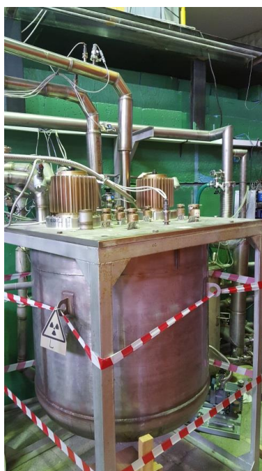
Рисунок 68. Теплообменник с 2-мя газодувками на канале № 3 для КЗ 202 и стенда КЗ 201.
