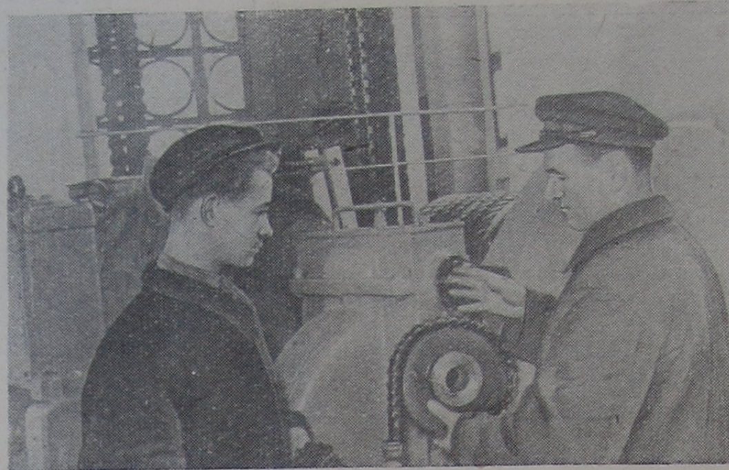
Много лет трудится на канале механик Большевожского шлюза А. В. Долгий. Немало людей обучил он своему ремеслу. На снимке: А. В. Долгий объясняет ученику слесаря Анатолию Рычкову устройство ручного привода.
