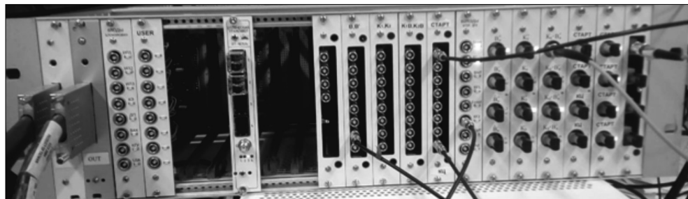
Рис. 1. Внешний вид циклозадающего крейта вместе с модулями ввода/вывода
