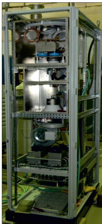
Рис. 3. Стойка ВЧ-генератора со снятыми стенками
