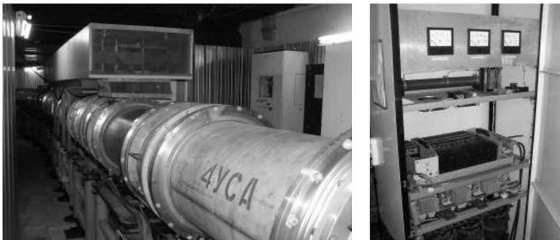
Рис. 12. а) Модернизированная ВЧ-станция в туннеле, б) стойка электроники для ВЧ-станций
