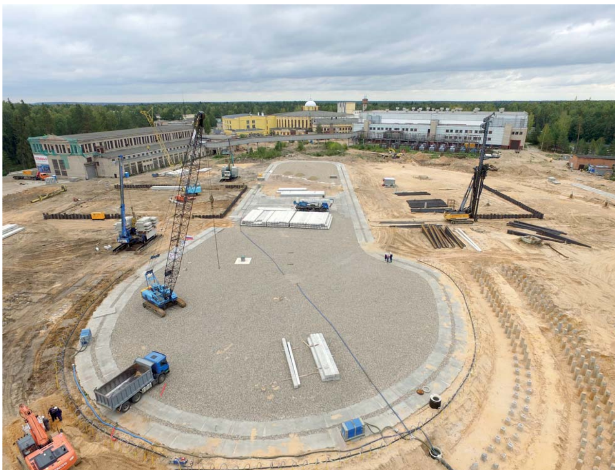
Лаборатория физики высоких энергий им. В. И. Векслера и А. М. Балдина. Строительная площадка комплекса NICA
