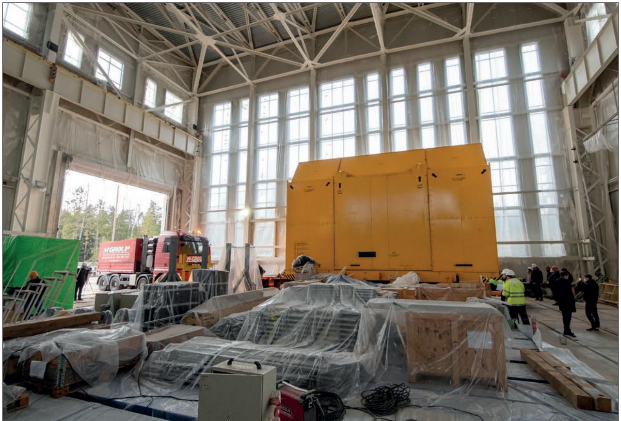
Дубна, 6 ноября. Сверхпроводящий магнит для детектора MPD доставлен на стройплощадку проекта NICA
